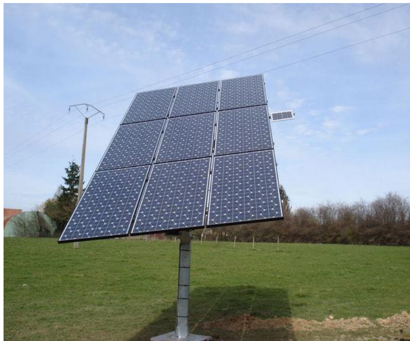
Fig.II.1. Panneau photovoltaïque avec suiveur à double axe [7].
