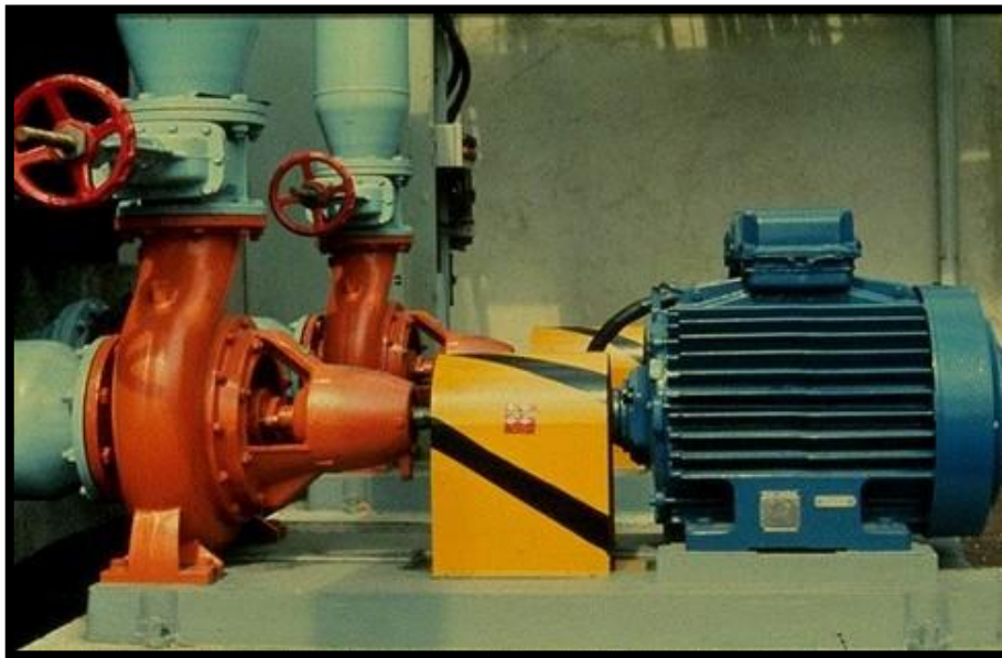
Figure N°04 - Pompe Centrifuge Avec Vannes Isolement
