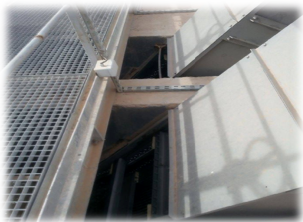
Figure 08 :Vue des dégrilleurs automatiques
