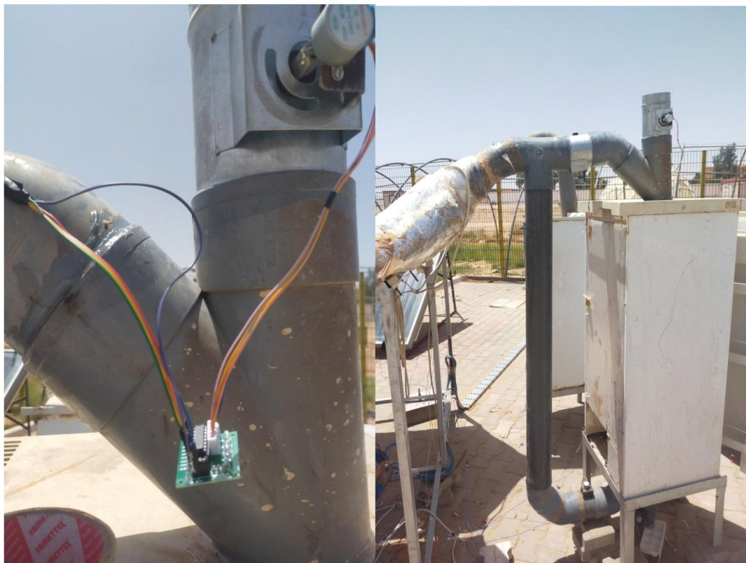
Figure 3.5 Les conduites et le système de gestion de l'air
