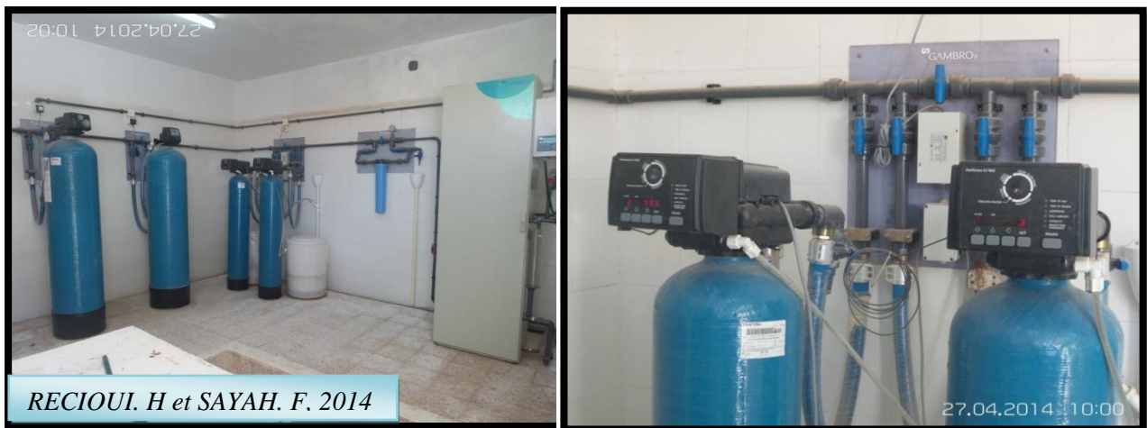
Fig 10 : Station de traitement des eaux pour l'hémodialyse
