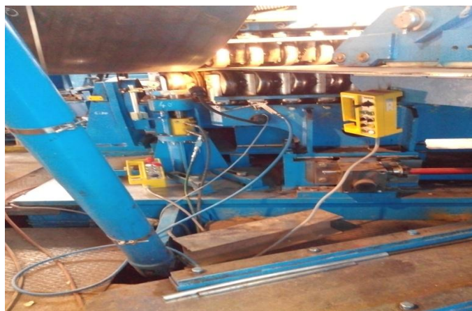
Figure II.14 : Commande de la fente de soudage.
