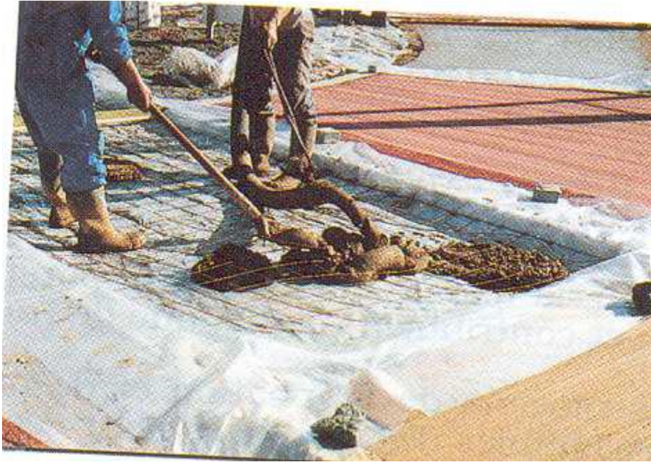
Figure. I- 6 : Dallage expérimental en béton da sable fabriqué à la Bétonnière et coulé en place. (Asma Jaballah Slaoui, 2014)
