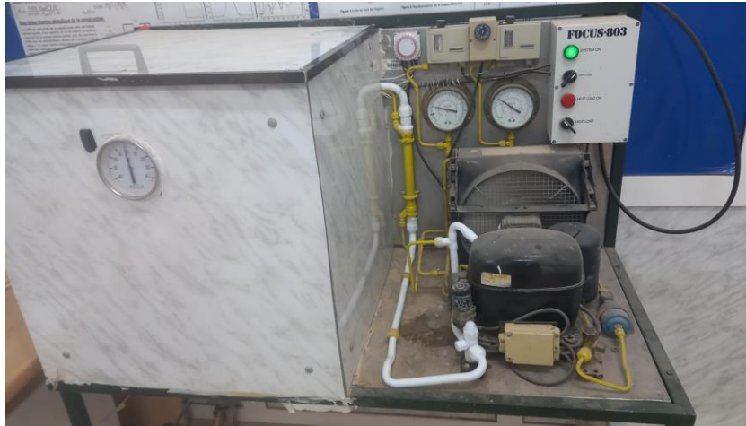
Figure 2.4 : Image illustrative indiquant la quantité de glace formée sur une partie du circuit frigorifique
