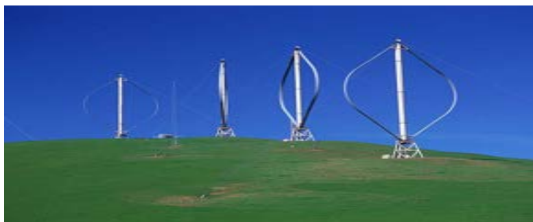
Fig 3. Éolienne à axe Vertical.
