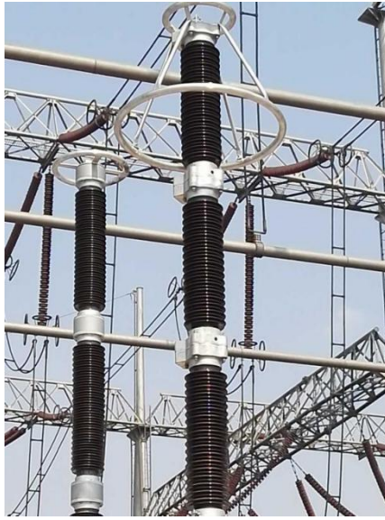
Figure I.35: Photos réel d'un parafoudre
