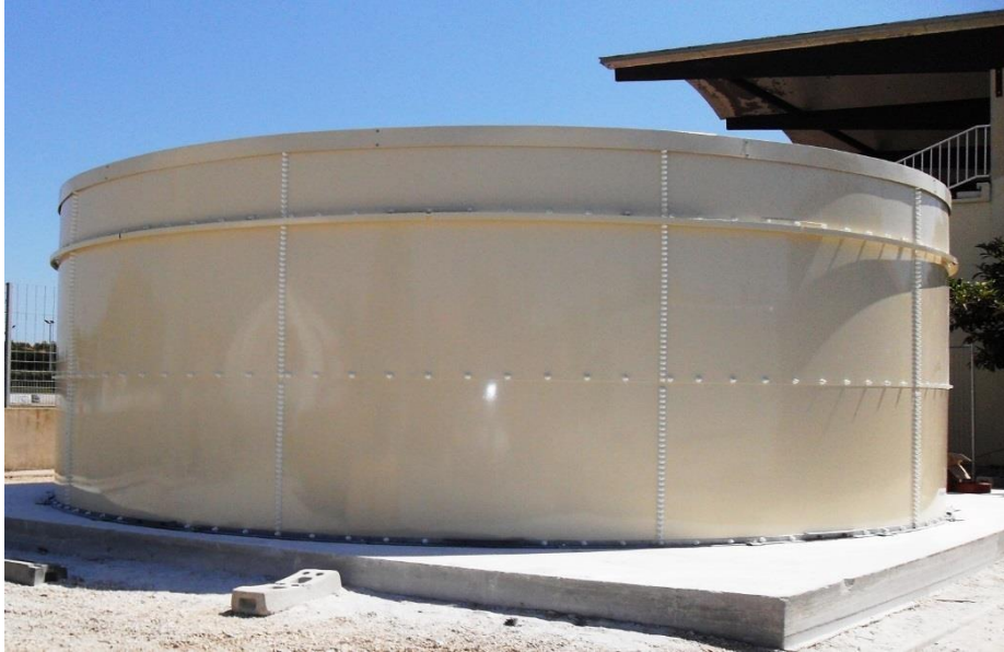
Figure19: réservoir de Stockage
