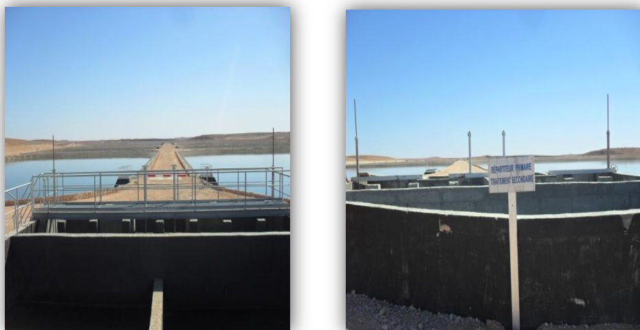
Figure II.23 Répartiteurs principales vers les bassins primaires et secondaires
