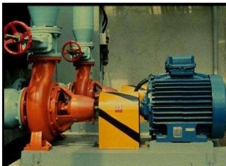
Figure 06: Pompe centrifuge avec vannes isolement
