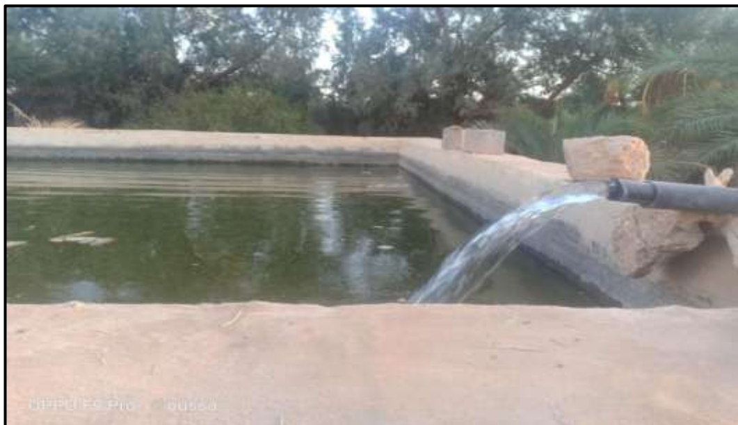
Figure 40 : le bassin existant.
