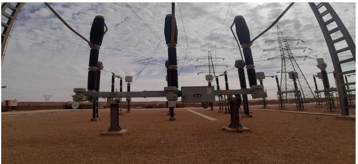
Figure I.7: Photo d'un disjoncteur HT.
