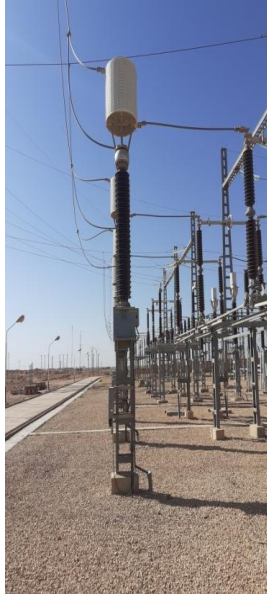
Figure I.9:Photo d'un transformateur de tension TT.
