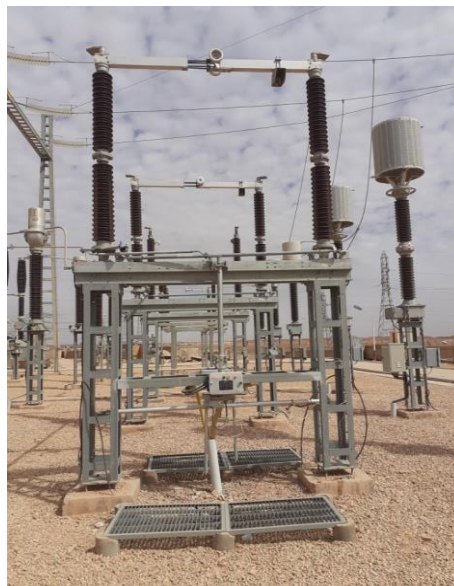
Figure I.6: Sectionneur tête de ligne et mise à la terre (malt).
