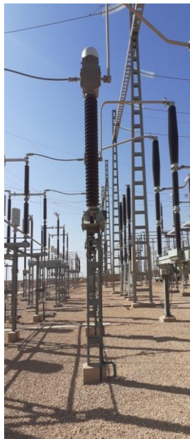
Figure I.8: Photo d'un transformateur de courant TC.
