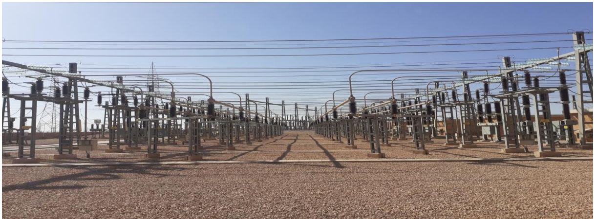
Figure I.3:Photo des travées HT dans un poste électrique.
