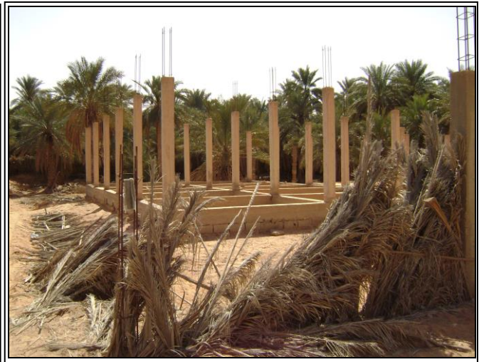
Photo N° 07: Le béton ravage la palmeraie.
