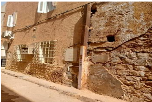
Figure 109 : remontée capillaire au niveau de mur de la façade « maison 1 » [20]
