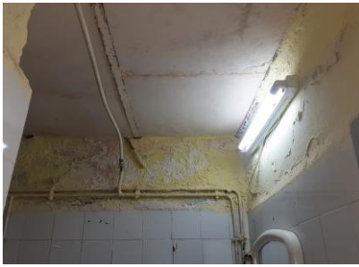
Figure 133 : présence de moisissures (champignons) et les insectes de « maison 2 »
