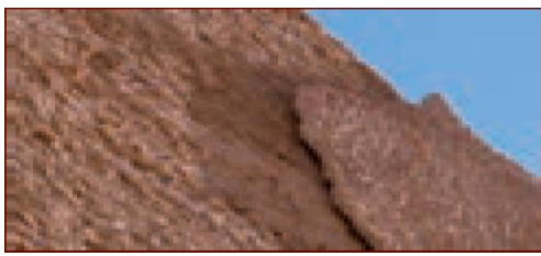
↓ Figure 113 : revêtement délabré
