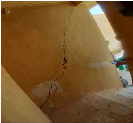
Figure 127 : fissure oblique de maison1 [20]
