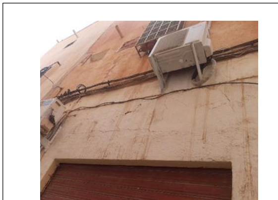
Figure 110 : dégradation de façade de « maison2 » [20]
