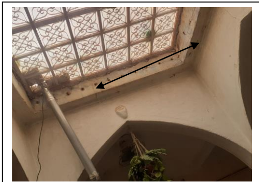
Figure 123 : fissurations démarrant à la hauteur de la toiture, « maison 1 » [20]
