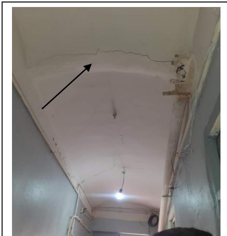
Figure 135 : fissure horizontale au niveau de plafond de « maison2 [20]
