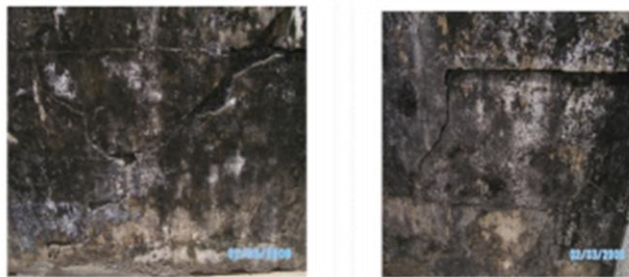
Figure 102 : vues sur les mouvements des fondations [35]
