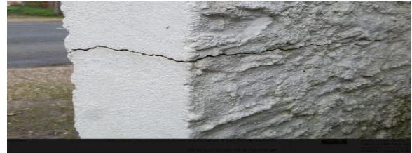
Figure 79 : fissures traversâtes sur mure ancienne [54]
