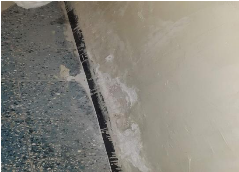
Figure 136 : détachement de revêtement à l'intérieur de « maison2 » [20]
