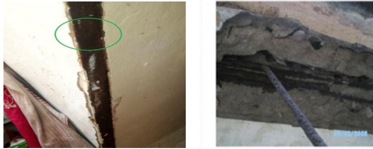
Figure 101 : la corrosion dans maison de Ghardaïa [26]
