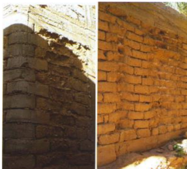
Figure 68 : l'incompatibilité des matériaux dans la structure porteuse [28]
