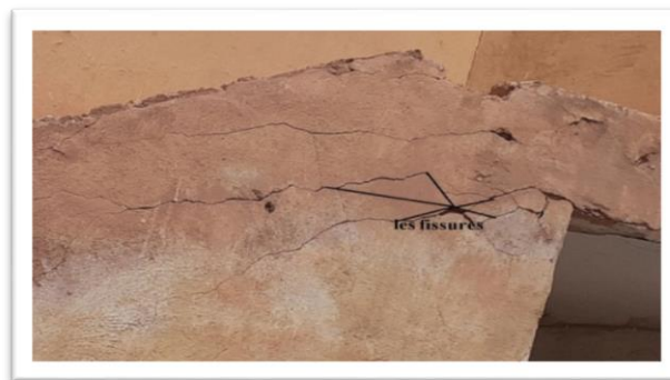
Figure 76 : les fissures fines [20]
