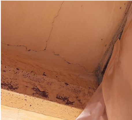
Figure 126 : Fissure : -au niveau de plafond de « maison 1 » [20]
