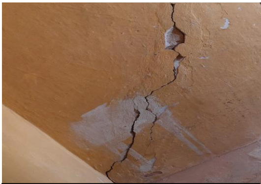
Figure 128 : détachement de revêtement et fissure oblique de maison1 [20]
