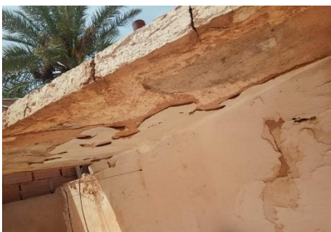
Figure132 : effondrement de toiture de maison2 [20]
