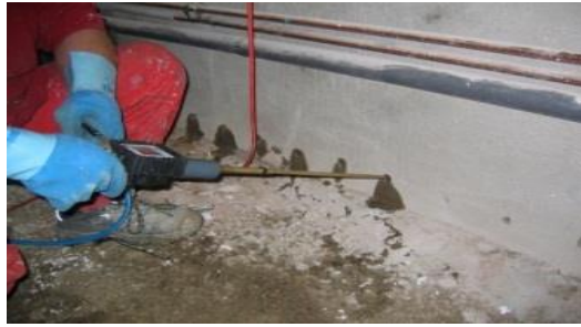
Figure 89 : Bas de mur traité par injection de résine [46]
