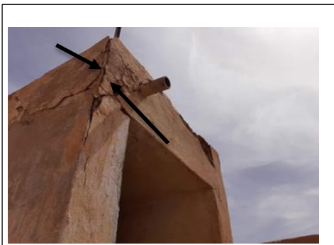
Figure 124 : dégradation de toiture de « Maison 1 » [20]
