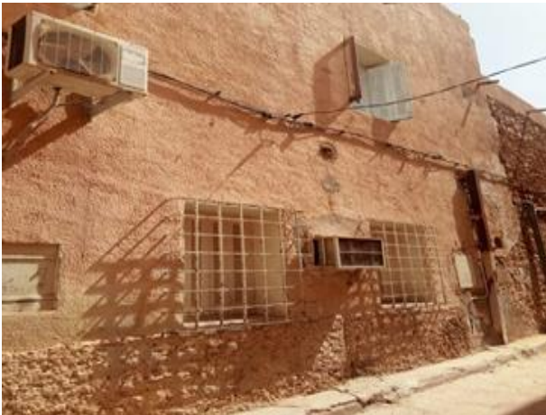
Figure 108 : dégradation de façade de « maison1 » [20]
