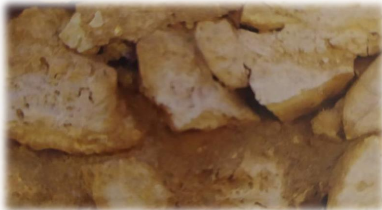
Figure 92 : détérioration des pierres. [44]
