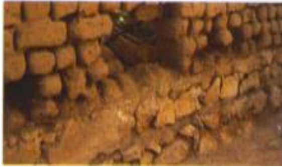
Figure 67 : effondrement de construction en argile à cause des eaux des crues [28]
