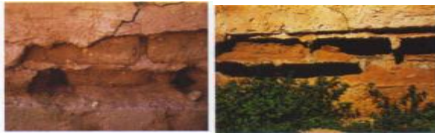
Figure 69 : hétérogénéité de mortier utilisé entre les adobes [28]
