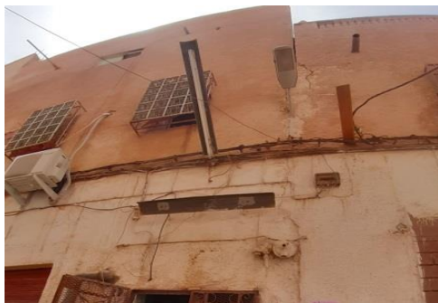
Figure 212 : remontée capillaire et fissure de « maison2 » [20]
