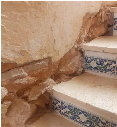
Figure 129 : Dégradation des escaliers de « Maison 1 » [20]
