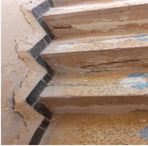
Figure 138 : Revêtement à l'escalier en marbre abîmé [20]
