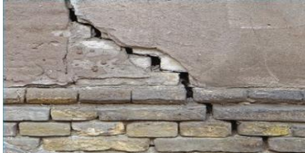
Figure 78 : fissures en escalier [52]
