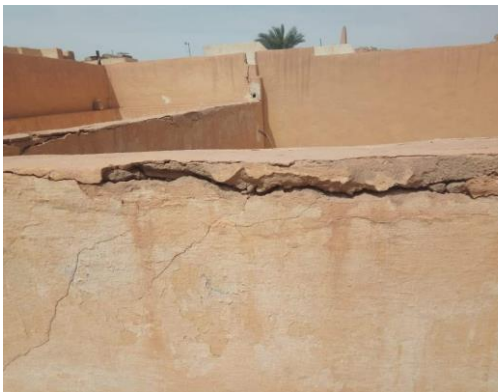
Figure 131 : fissurations de toiture de maison2. [20]
