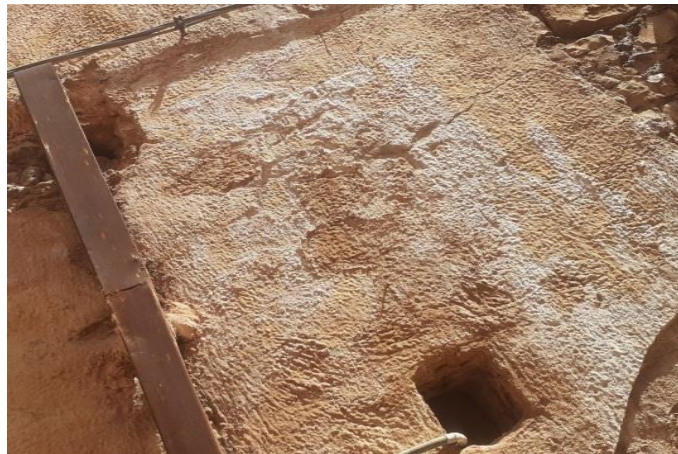
Figure 88 : L'apparition d'humidité sur l'interface [20]
