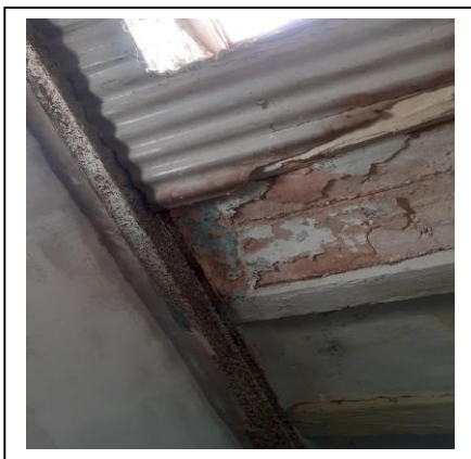
Figure 125 : Corrosion des aciers Sur le plancher de « maison 1 » [20]
