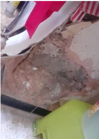
Figure 130 : Dégradation de mur de « maison 1 » [20]
