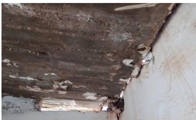
Figure 134 : dégradation de plancher de « maison 2 » [20]
