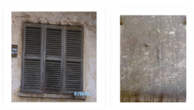
Figure 98 : vue sur l'encrassement [35]
