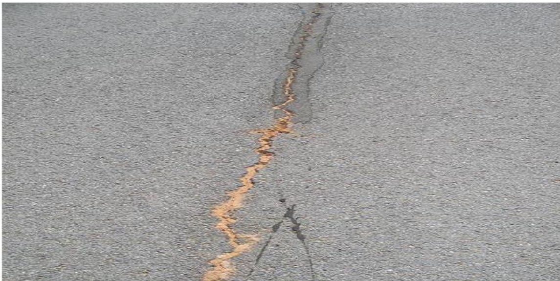
VI -3 Fissure de joint d'un niveau élevé. Réparation dégradée
