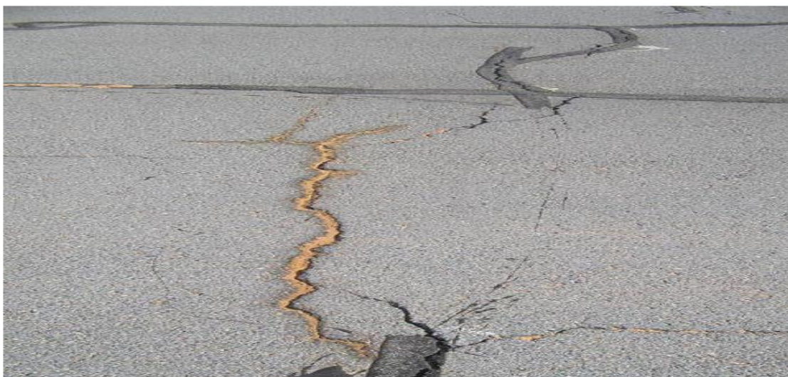
VI- 4 Fissure de retrait élevé Réparation dégradée
