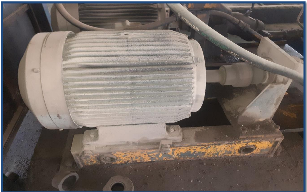
Photo N° 20 : Le moteur a cessé de fonctionner d ALFAPIPE GHARDAIA
