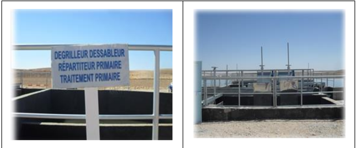
Figure II.2 : dégrilleur et dessableur.
