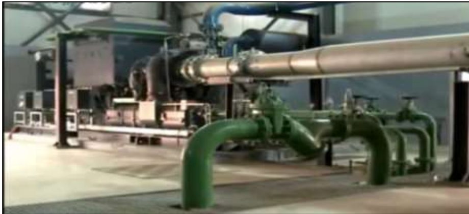
Figure I.7: Le compresseur recyclage a 26 bars.
