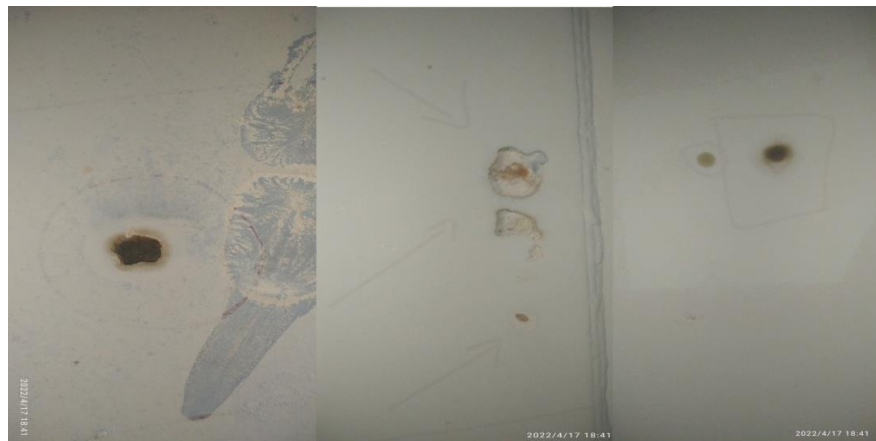
Photo III-16: Corrosion des parois côté intérieur du bac de stockage T02110
