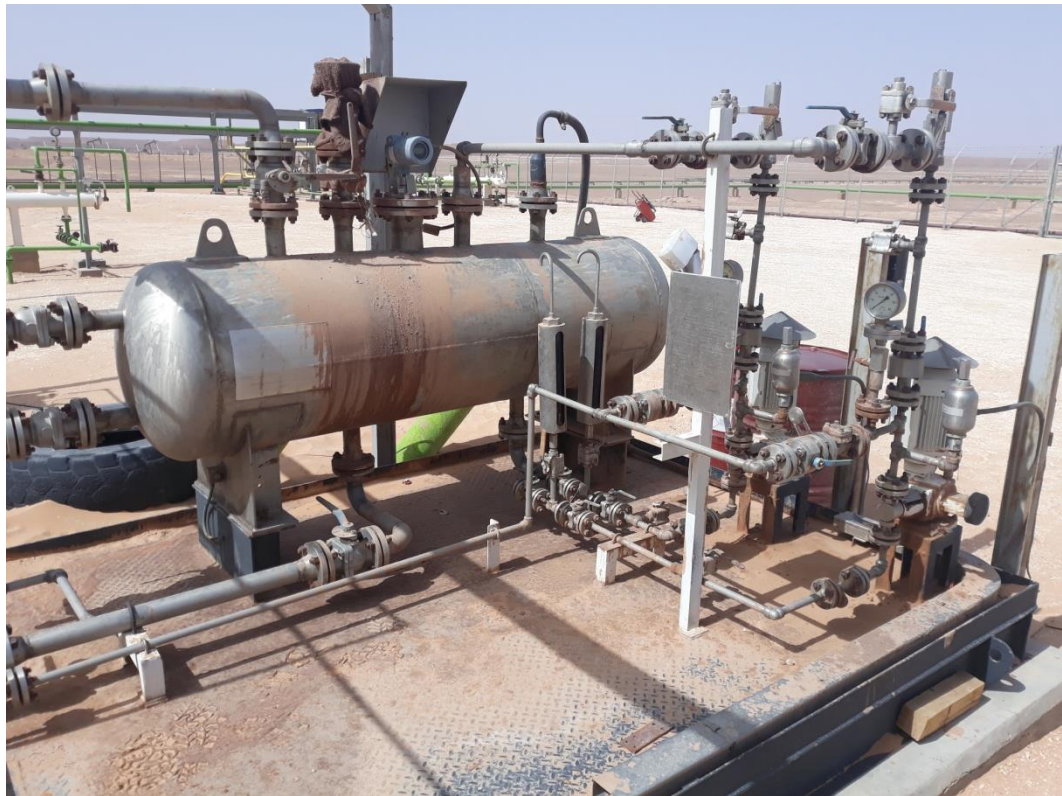
Photo I-1 : Unité d'injection d'inhibiteur de corrosion
