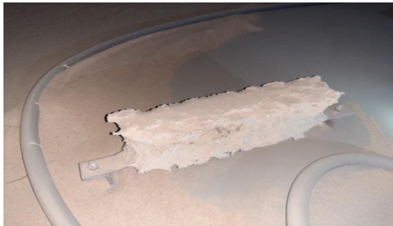
Photo II-1 : Anode sacrificielle corrodé (bac de stockage T02110 CPF)
