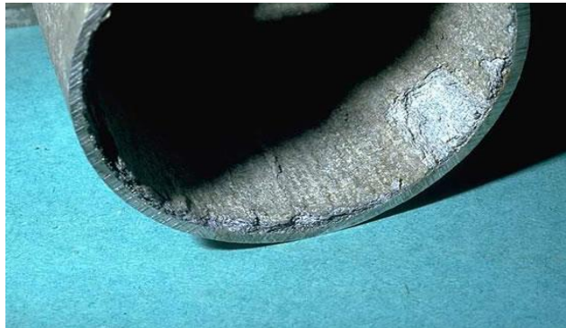
Figure II-5 : Corrosion feuilletant d'une canalisation en alliage d'aluminium [14]
