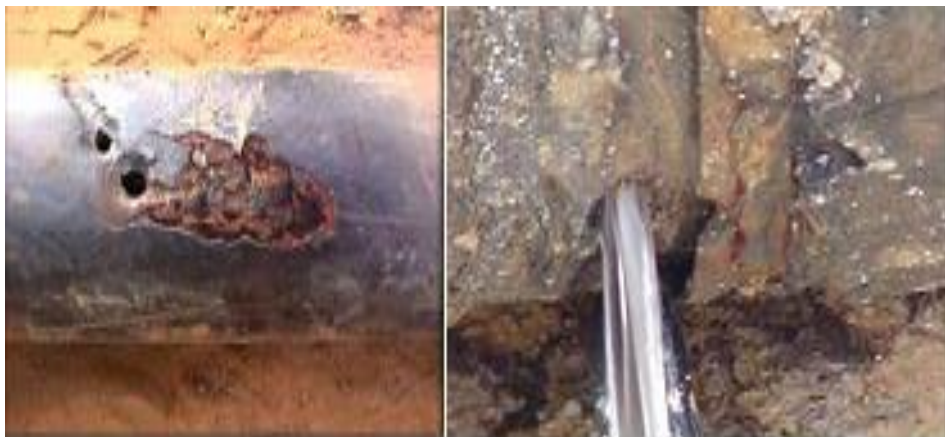
Figure II-12 : Etat d'un pipeline endommagé [15]
