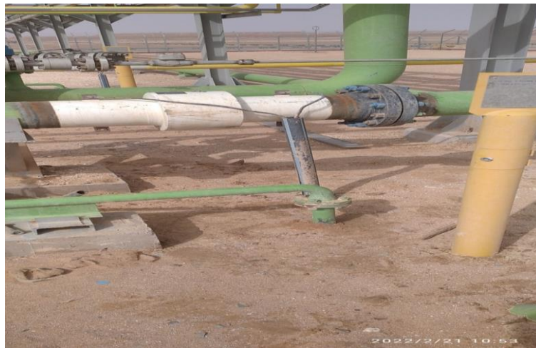
PhotoII-3 : Protection cathodique pour pipeline OUT vers CPF (TOUAT HUILE ADRAR)
