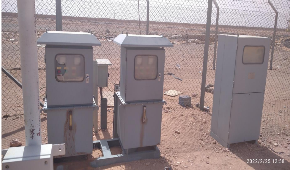
Photo II-2 : Poste de soutirage pour le système de protection cathodique CPF
