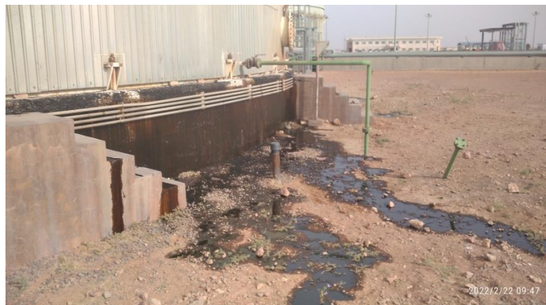
Photo III-15 : Percement du bac de stockage 02110 CPF
