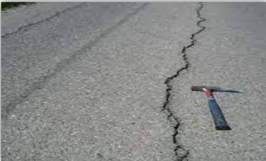
Figure N° 10: Fissuration de la chaussée. [43]
