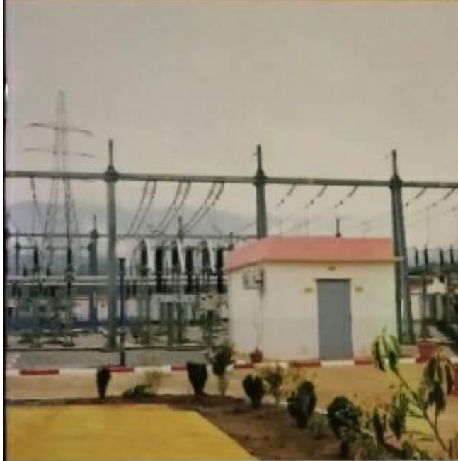
Transfert des ouvrages 60kV à la Distribution
