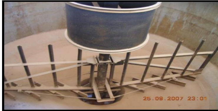
Figure II-23: Cuve d'épaississement de boues.[44]
