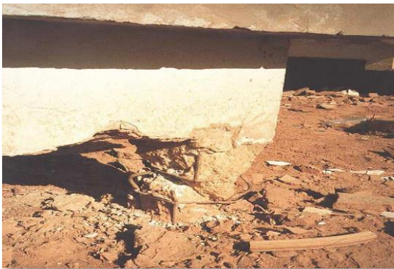
Photo I-3 : Cisaillement au niveau des nœuds (Derriche Z Et al.).
