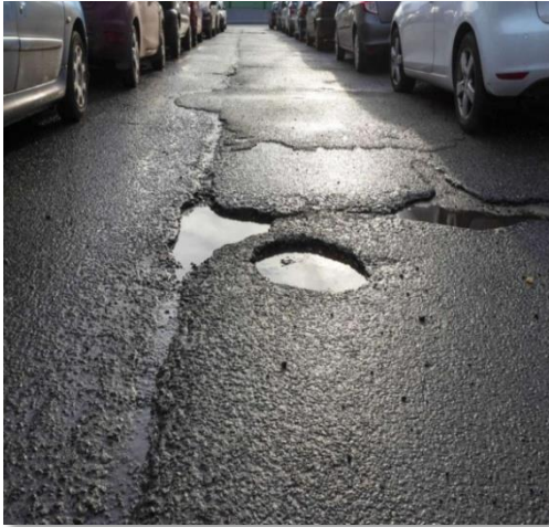
Photo I- 5: Dégradation de Chaussées
