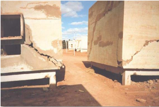
Photo I-1 : Fissures diagonales (Derriche Z et al.)
