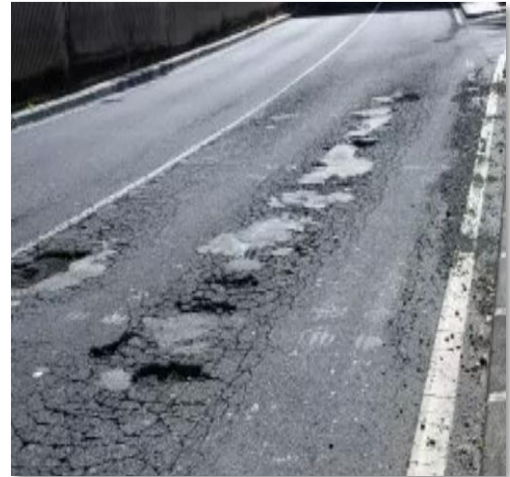
Photo I-6: Dégradation des routes
