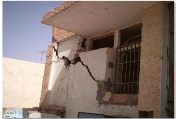
Photo I-2 Fissure sur les murs (Zenkhril, 2010).
