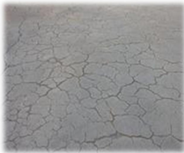
Figure I- 16. Fissuration de peau du béton (17).
