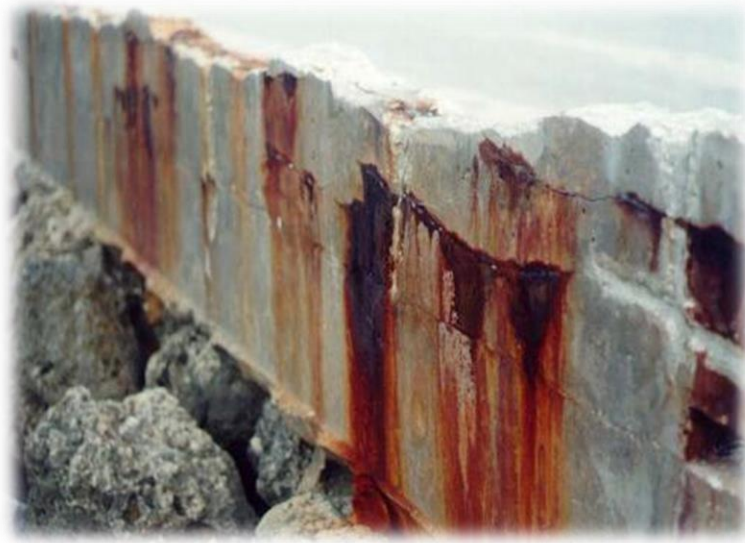
Figure I- 15. Corrosion des armatures. (16).
