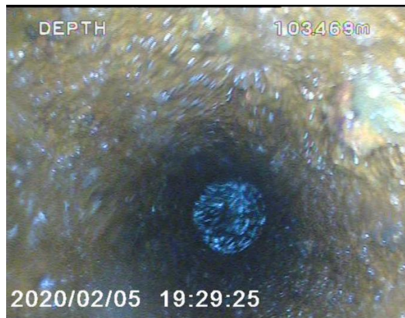
Figure 29: l'état de tubage au niveau 103m par endoscopie
