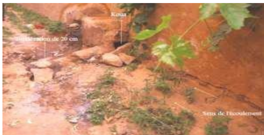
Figure III.28. Une koua fermée par des roches représente un danger pour l'oasis en période de crues (Photo. Remini, 2019)
