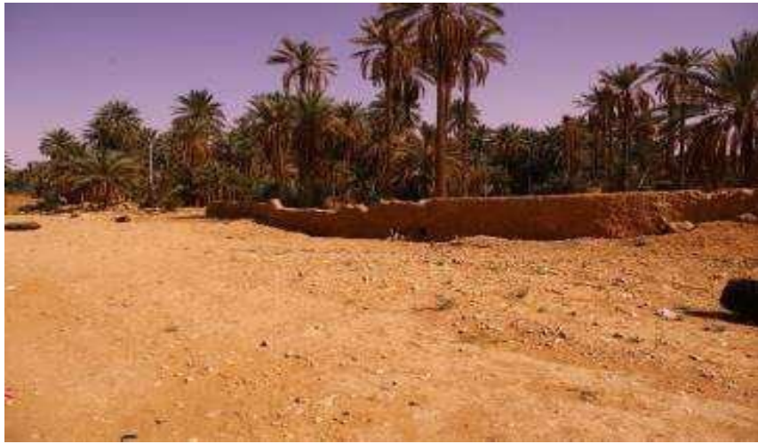
Figure III.9. Une vue de la digue du grand barrage Si Lekhel (Photo. Remini, 2019)
