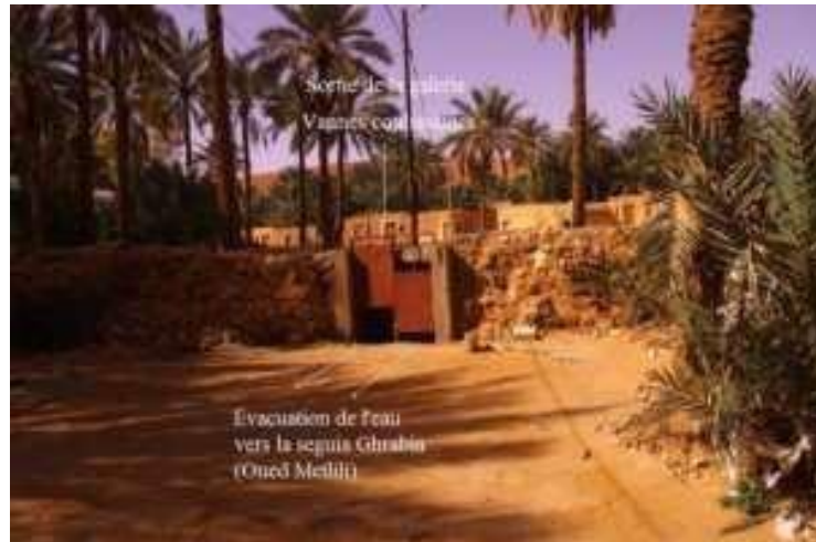
Figure III.52. La sortie de la galerie d'évacuation des eaux pluviales Par de portes coulissantes (Photo. Remini, 2019)
