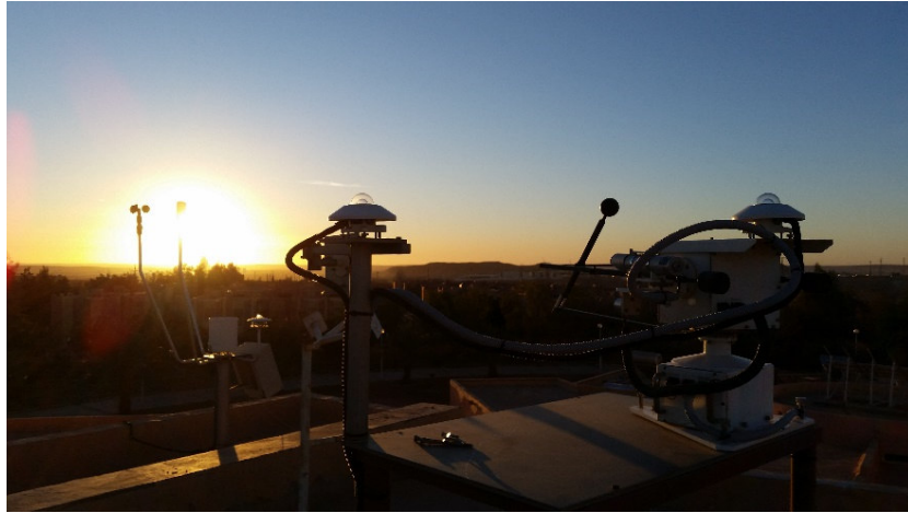
Figure III.12 : Station radiométrique de l'URAER (Ghardaïa).
