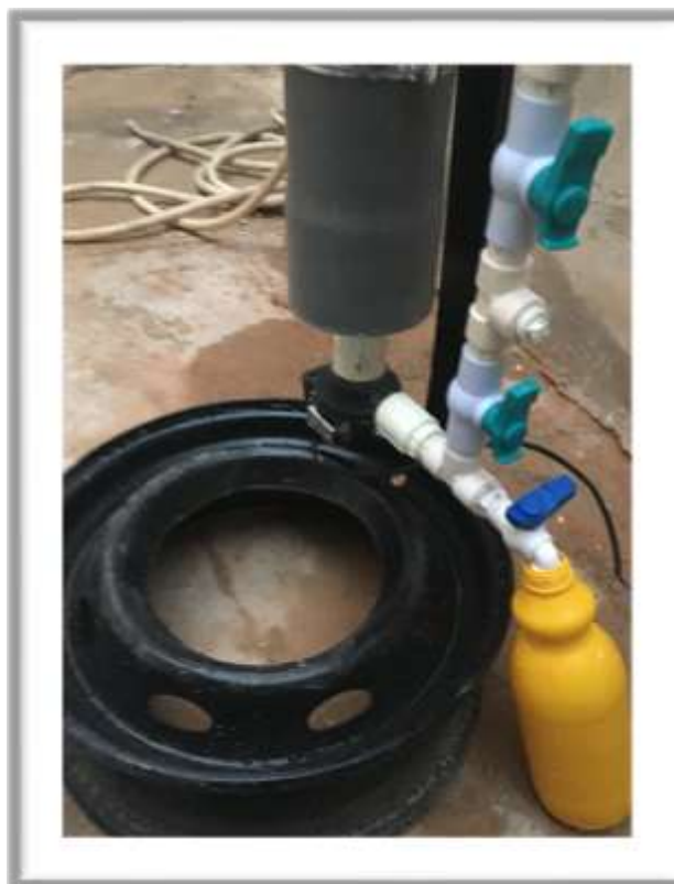
Figure 15: Bas de la colonne et vanne de récupération de Javel
