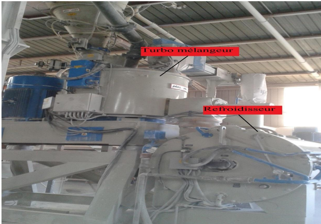
Fig. I. 2. La figure montre le turbo-mélangeur et le refroidisseur.
