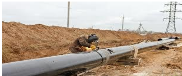
Figure II.1 : Pipeline dans l'environnement [6]
