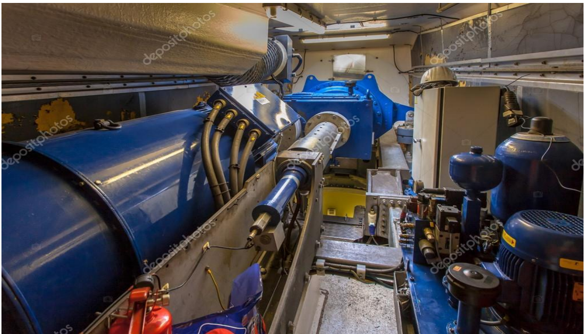
Figure I.12: à l'Intérieur de Nacelle d'éolien vent avec essieux, boîte de vitesses, embrayage et système de refroidissement.
