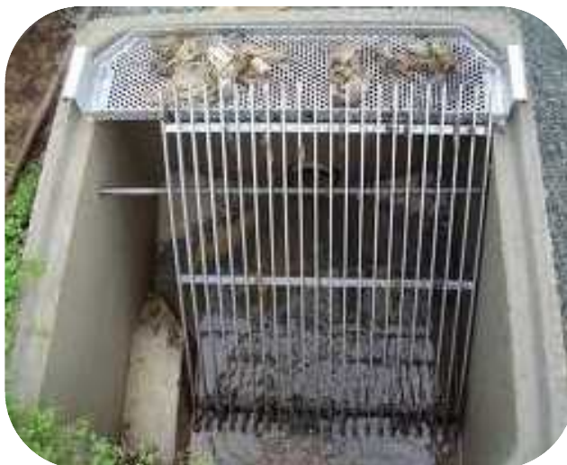
Figure III-1. Dégrilleur manuel ( AERM, 2007 )
