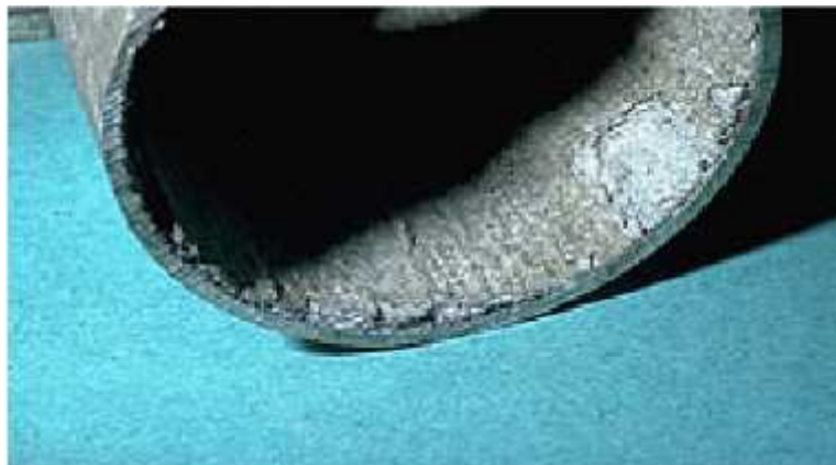
Figure I.V : corrosion feuilletant d'une canalisation en alliage d'aluminium véhiculant de l'eau. [07]
