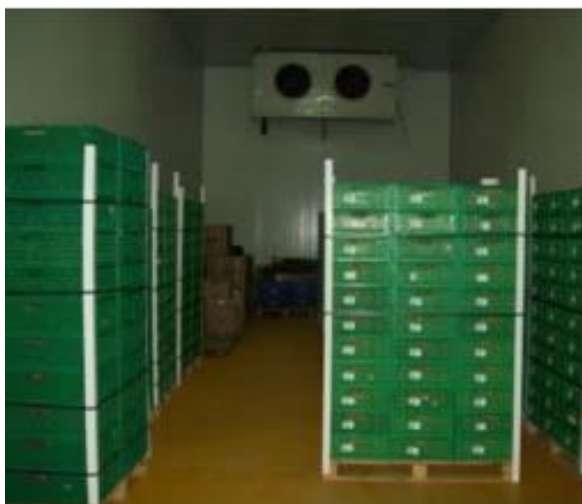
Figure 02: Chambres frigorifiques de stockage de dattes
