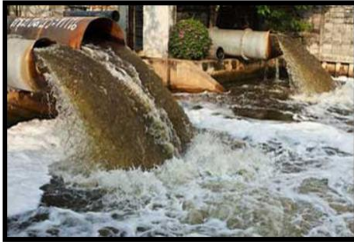
الصورة 7 : توضح مياه الصرف الصحي ملوثة [جمعة محمد سلامة، الاستخدام البيئي لمياه الصرف الصحي]
