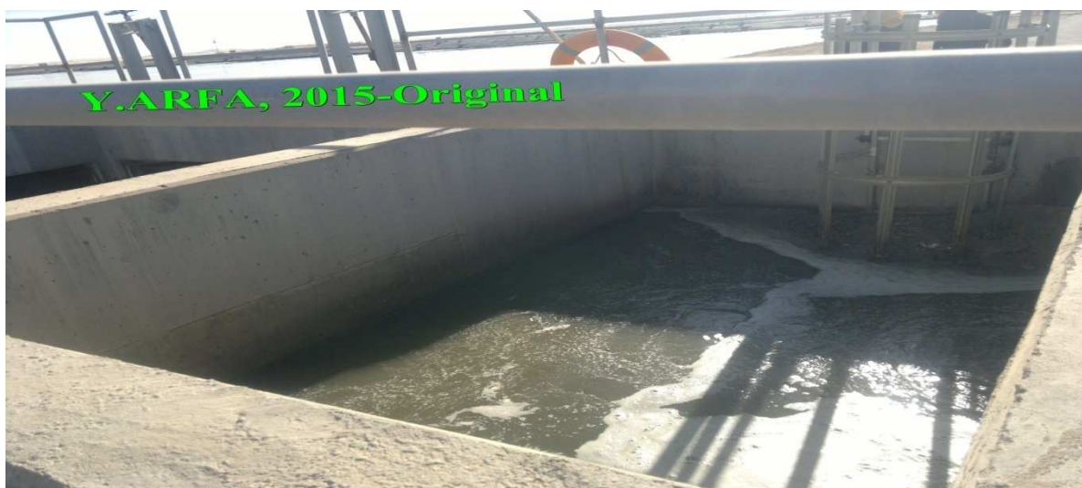
Photo11 : Répartiteur (vue intérieur) «Original»
