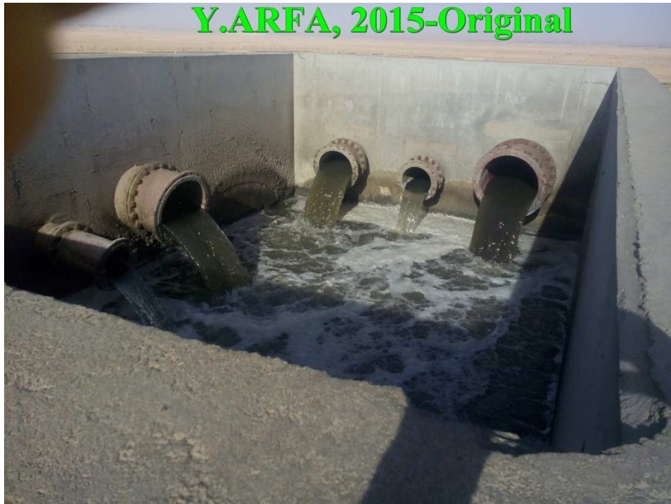
Photo 4: Bassin de dégazage avec les cinq conduites de collecte. «Original»
