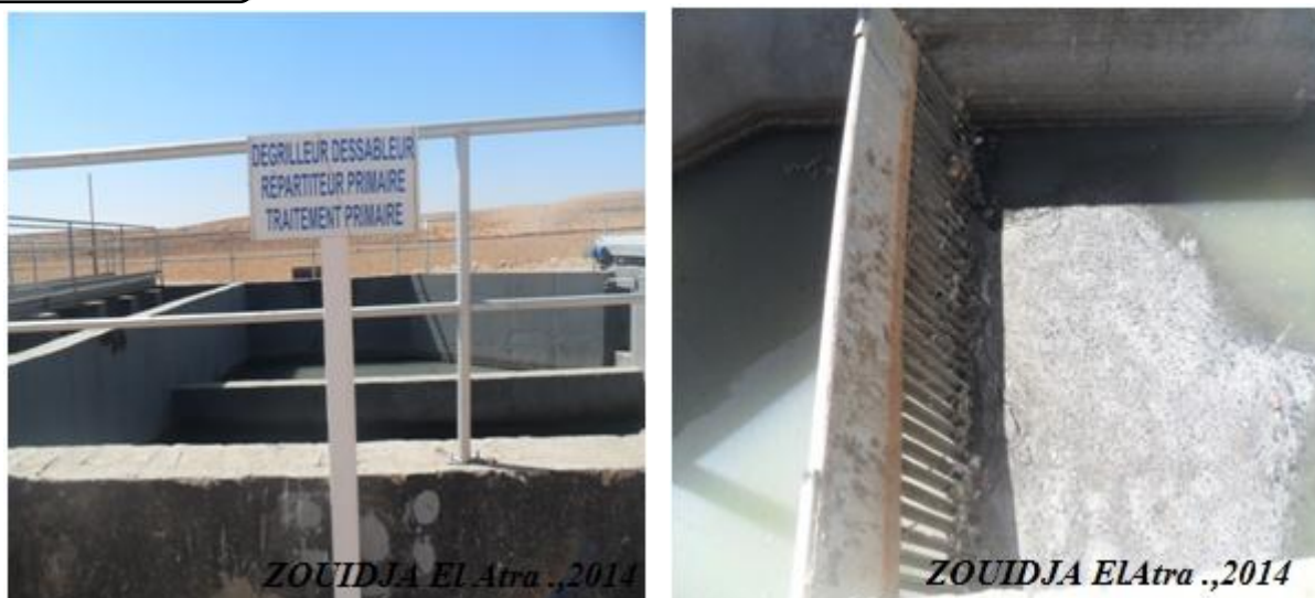
Photo 3.3. Dégrilleur et dessableur (Photo originale Mai, 2014)
