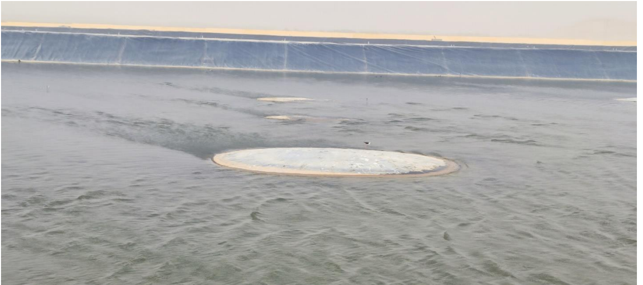
Gonflement de la gèomembrane (indique la présence de gaz)
