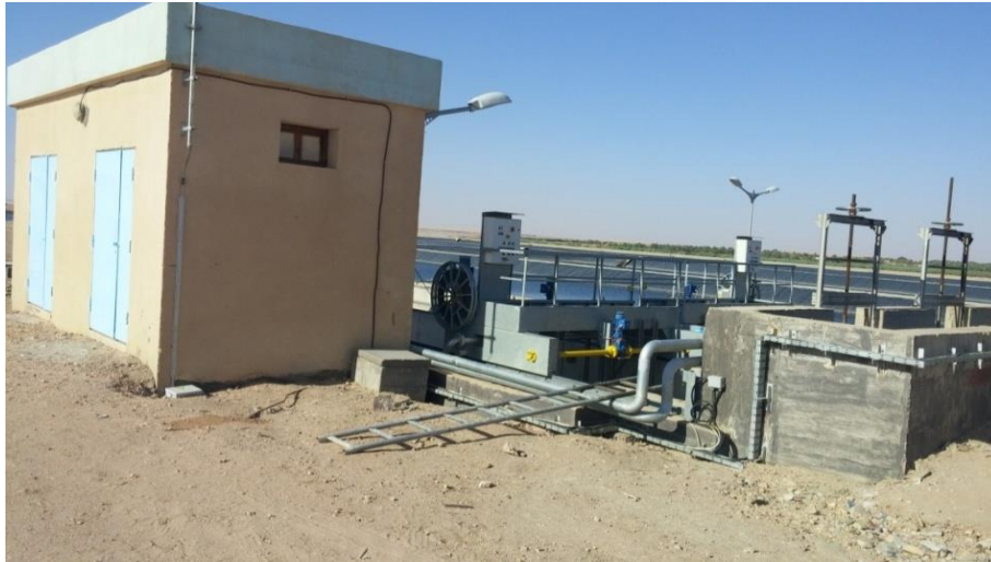
Figure 4IV: Les ouvrages de prétraitement
