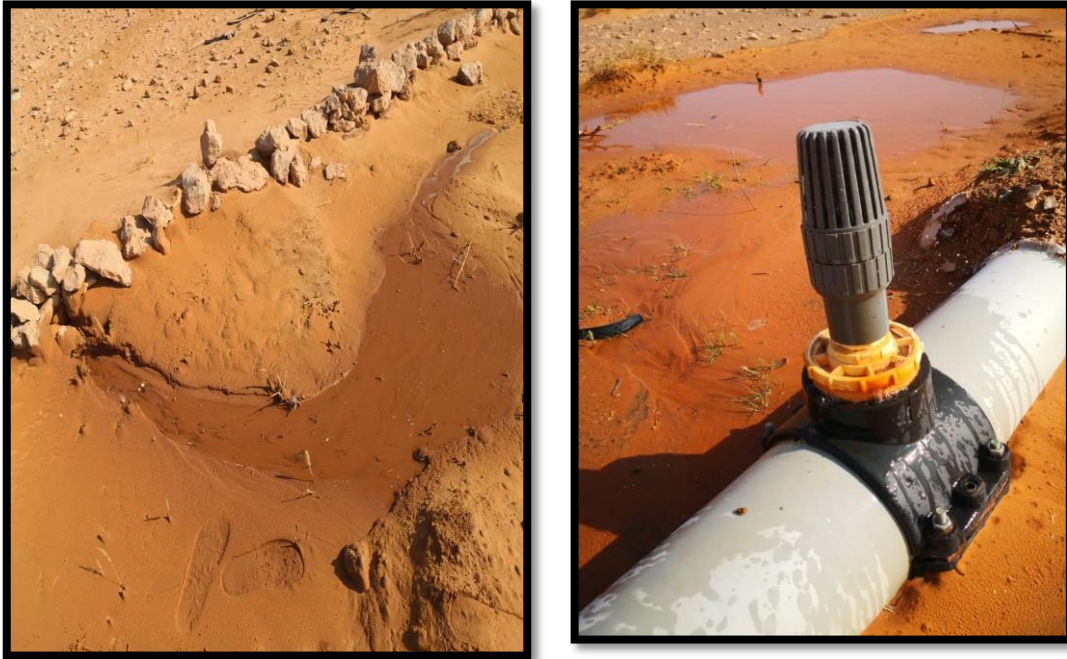
Figure 23 : Fuites dans la conduite.
