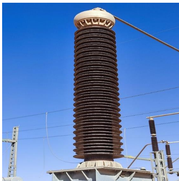
Figure II.13 : Transformateur de tension TT/TP
