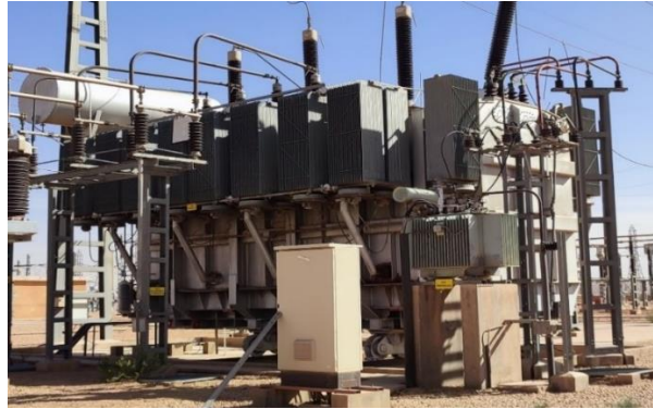
Figure II.9 : Transformateur HTB 220/60 Kv
