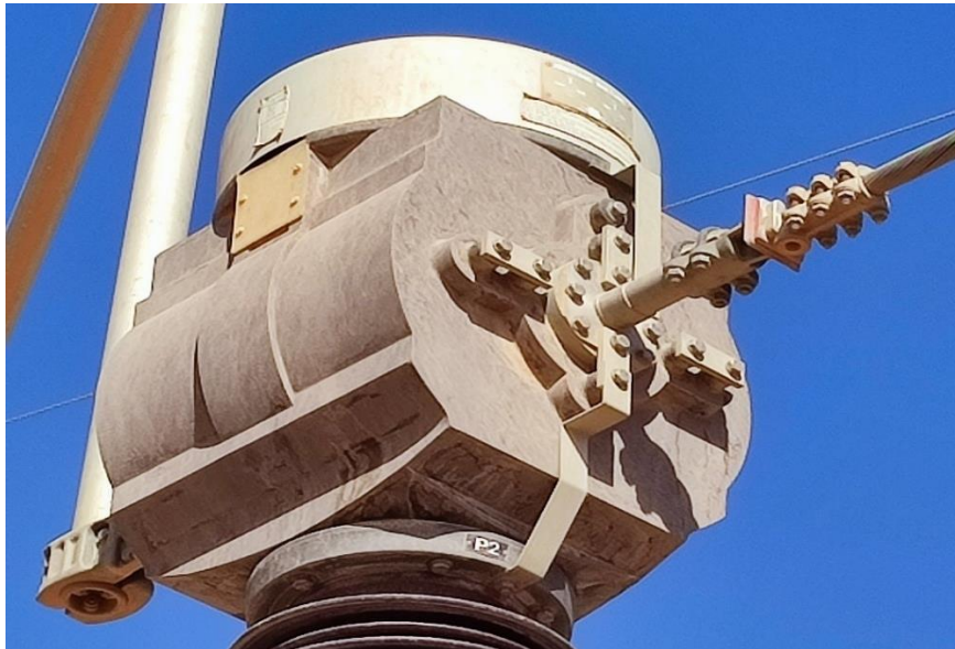
Figure II.11 : Transformateur de courant (TC)
