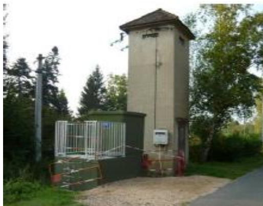
Figure 2-5 Poste de distribution cabiné.
