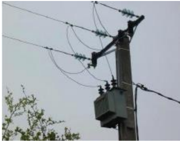
Figure 2-4 Poste de distribution sur support.
