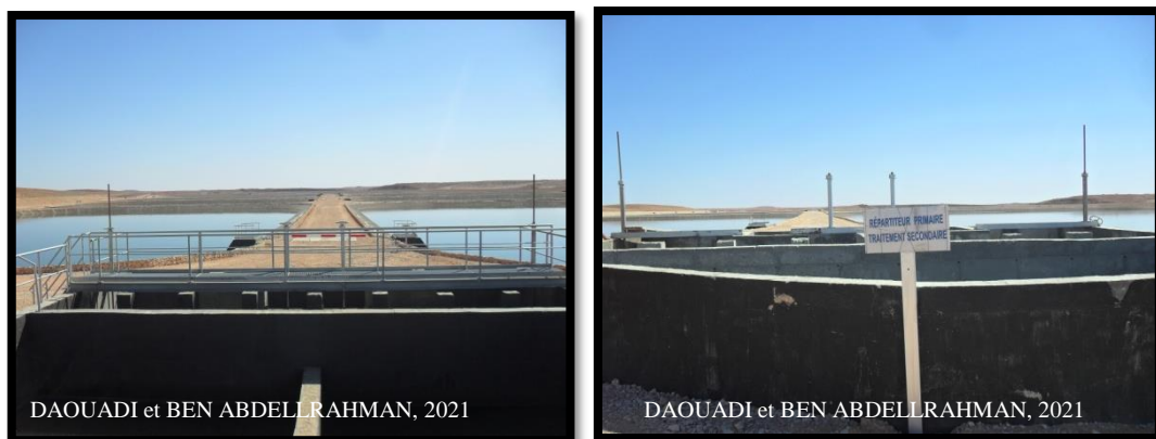
Photo 14 : Répartiteurs principales vers les bassins primaires et secondaires (STEP, 2021)
