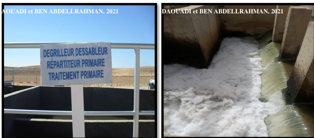
Photo 13 : Dégrilleur et dessableur (STEP, 2021)
