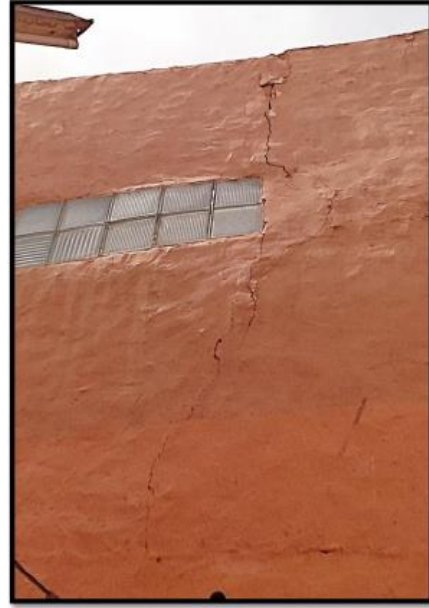
صورة (18): تشققات سطحية على الجدران الواجهة. [18]
