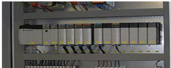
Figure 29 Automate de Allen-Bradley installé dans une armoire [19]
