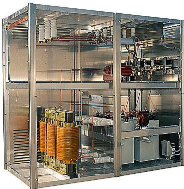
Fig.III.5 : Batterie automatique RECTIPHASE de compensation d'énergie réactive sur site industriel
