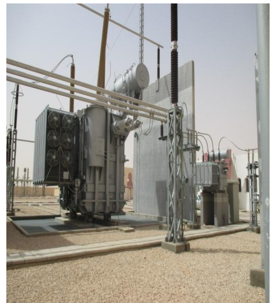
Figure 1 : transformateur dans le poste 400 KV HM
