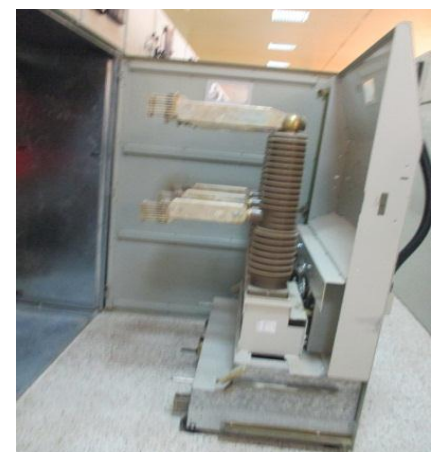
Figure 2 : Disjoncteur dans le poste HM 220/60/30 KV
