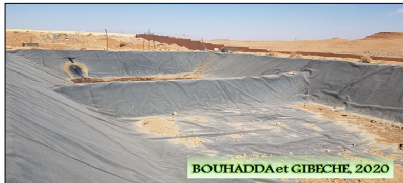
Figure 13 : Bassins de récupération de lixivat
