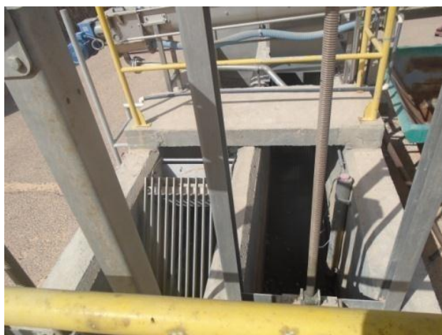
Figure III -2: Degrilleurs de la STEP Sidi khouiled.
