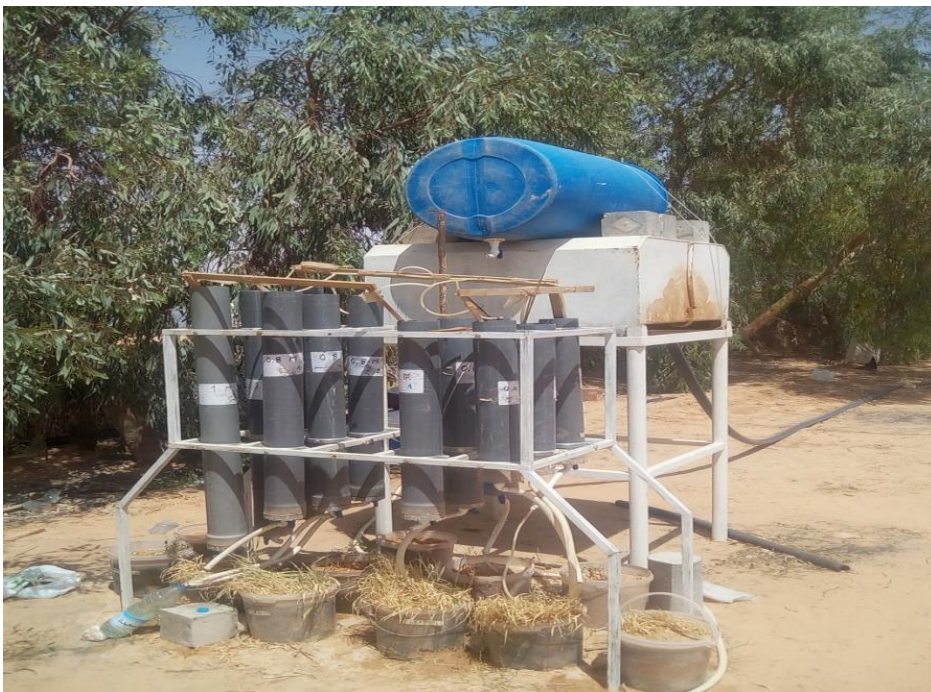
Figure N° 01 : Pilot de filtration
