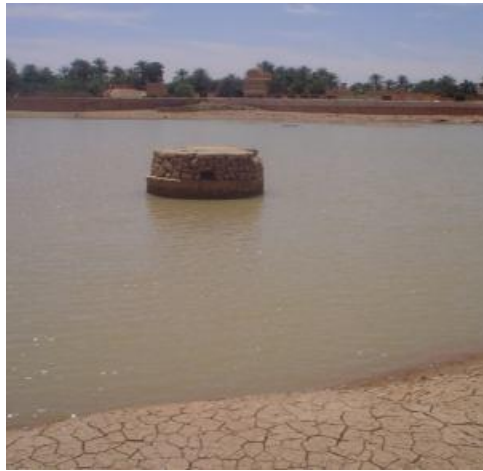
Photo III-7 : Puits capteur dans la retenue de barrage Bouchène
