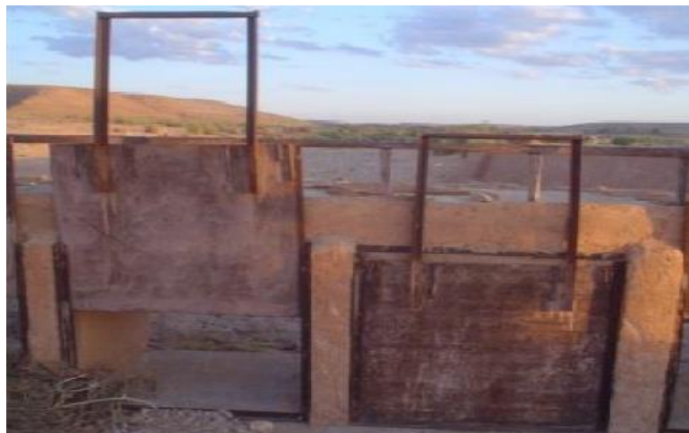
Photo III-2 : Vannes métallique de régularisation de débit
